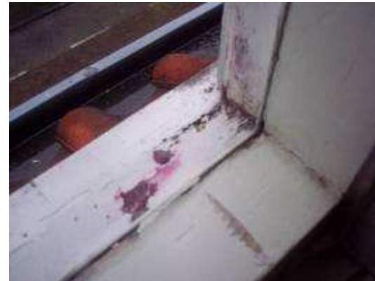
Houtrot kozijnen dakkapellen
