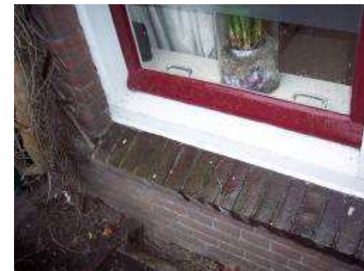
Ventilatierooster kruipruimte achterzijde
