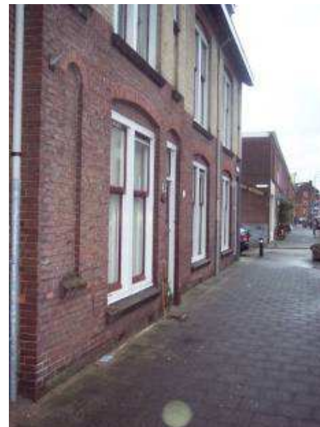
Ventilatieroosters kruipruimte voorzijde
