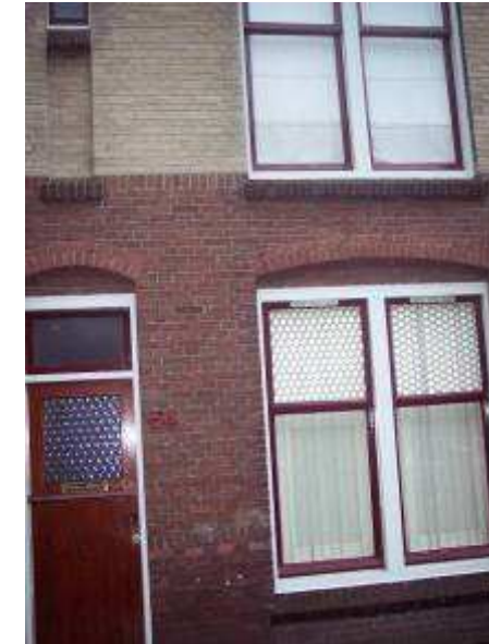
Scheurvorming matig boven en onder de kozijnen
