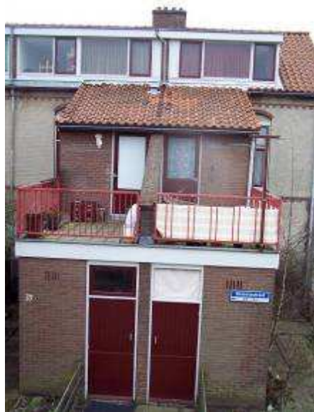
Balkonhekken op 3 plaatsen bevestigd
