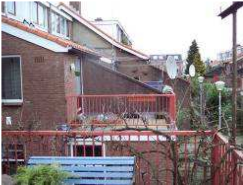
Slecht voegwerk rollaag
