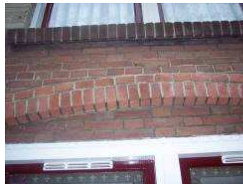
Scheurvorming nabij bogen en onder kozijnen
