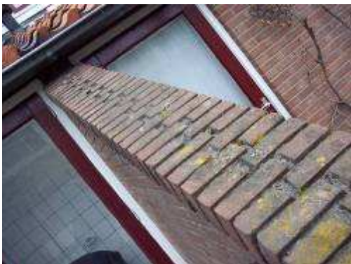
Slecht voegwerk rollaag
