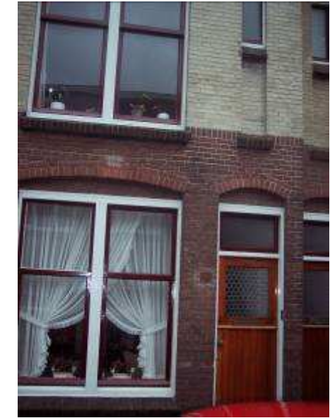
Beschadigde stenen t.p.v. voordeur
