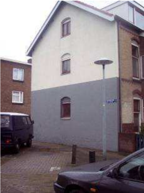
Lelijke reparaties. De ventilatieopeningen zijn verdwenen
